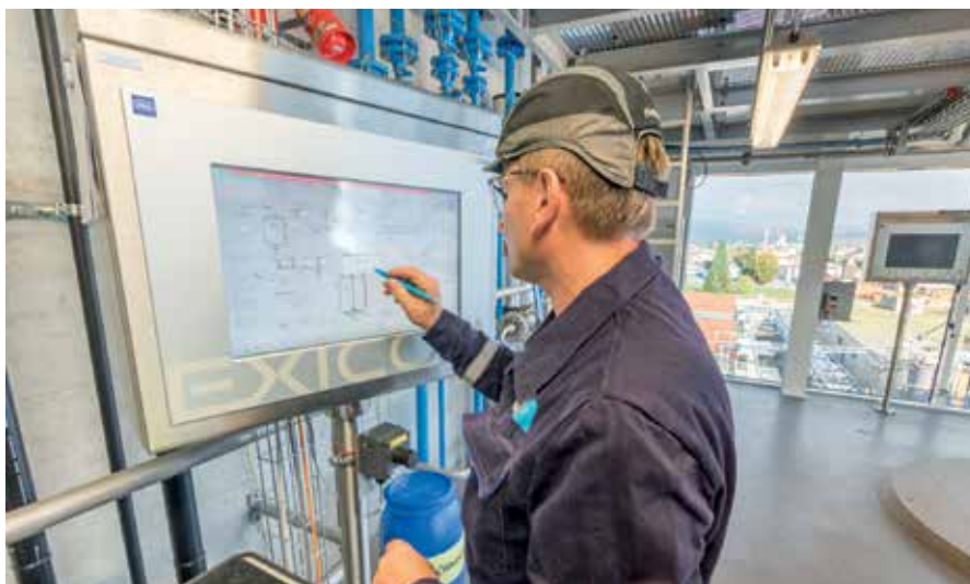
Ein Service-Mitarbeiter ist im Störfall innerhalb von 60 Minuten zur Stelle und kümmert sich darum, dass die Anlagenverfügbarkeit gewährleistet ist.
